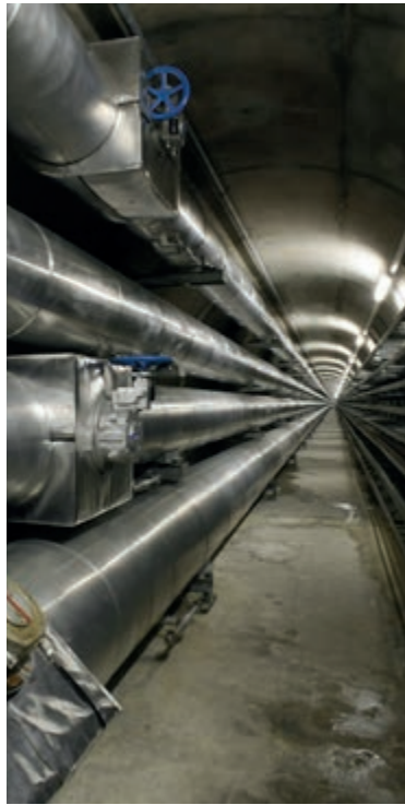
Ausgeklügelte Wärmeverteilung im Flughafen-Untergrund
