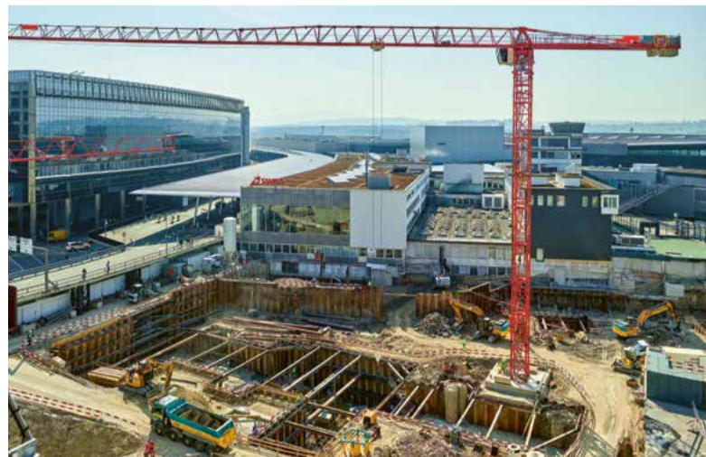
Die neue Gepäcksortieranlage grenzt direkt ans Terminal 1.
